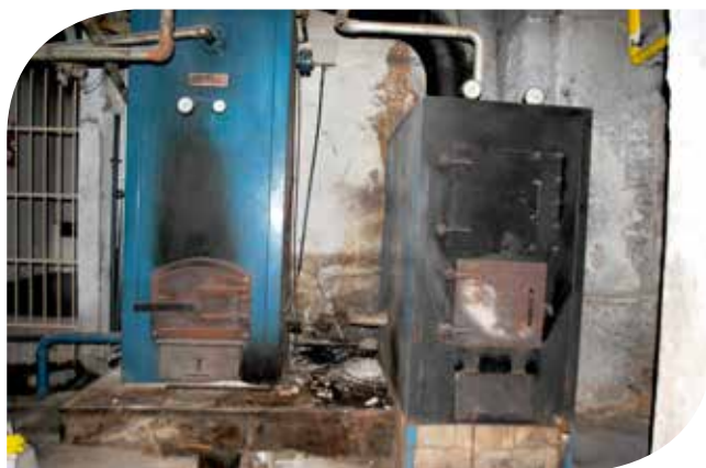
Caldeira a lenha era utilizada para abastecer o Edifício Linck
