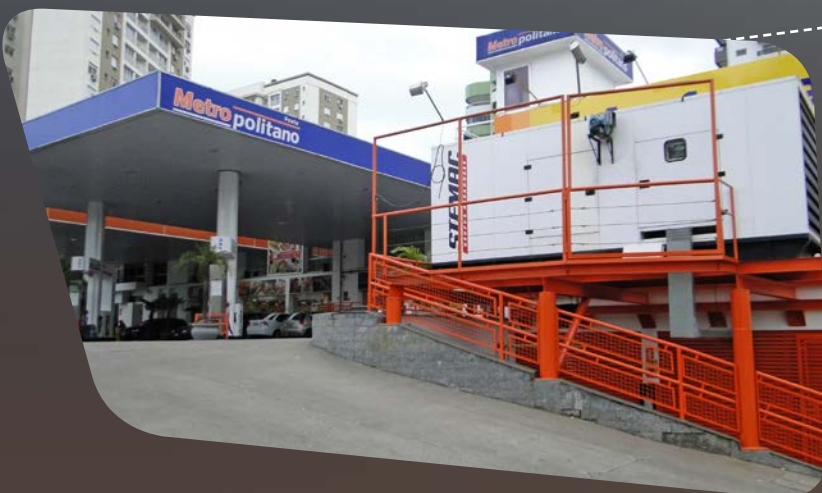
3 Gerador de energia elétrica para o posto
